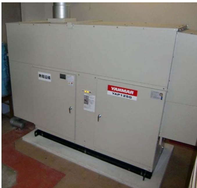
八開浄水場の非常用発電機
