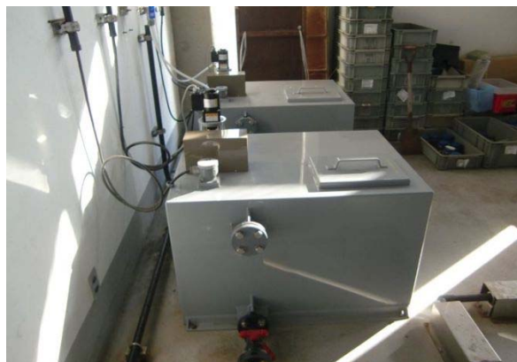
佐織中部浄水場次亜塩素注入装置
