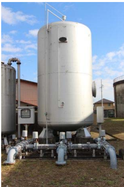
佐織中部浄水場の急速ろ過機
