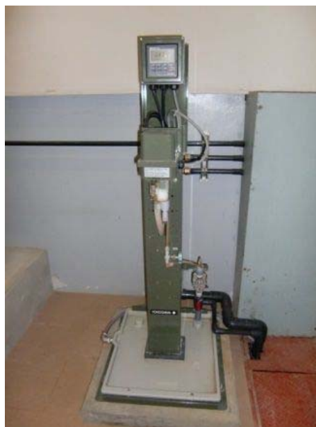
八開浄水場に設置されている残留塩素計
