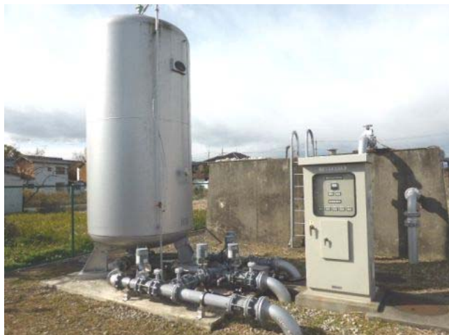
佐織西部浄水場の急速ろ過機
