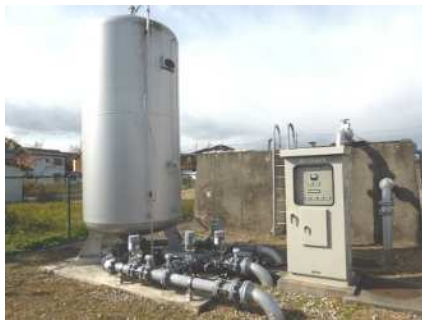
佐織西部浄水場の急速ろ過機
