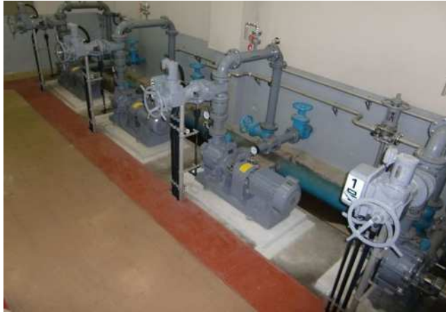
八開浄水場の配水ポンプ
