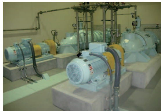
新設ポンプφ800×2台
