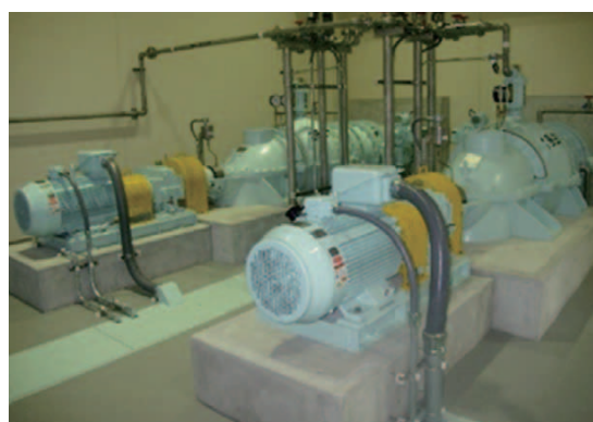
新設ポンプφ800×2台
