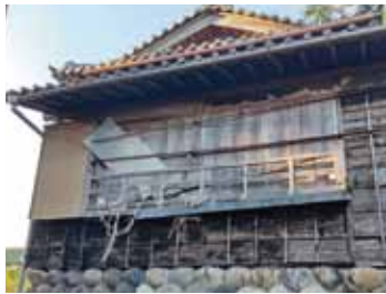
▲危険空き家の一例
