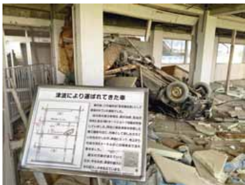
▲東日本大震災の震災遺構
