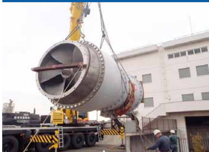
(孫宝第2排水機場の排水機)
