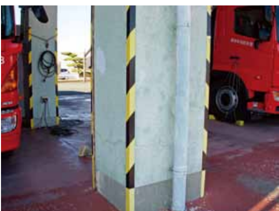
▲老朽化している消防施設(消防署分署)
