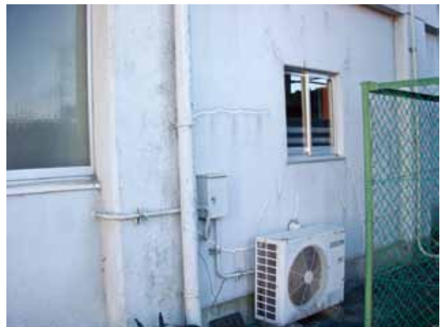
▲亀裂がある消防施設(消防本部)
