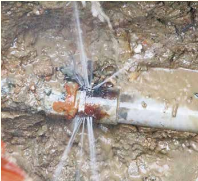
水道管劣化による漏水状況
