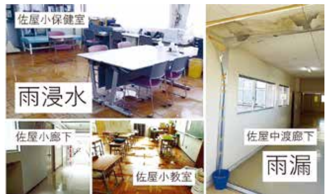
▲老朽校舎の雨浸水や雨漏
