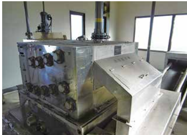
汚泥脱水装置
