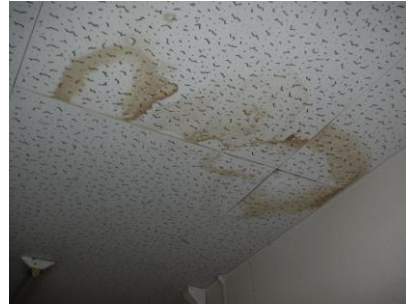
漏水等による劣化
