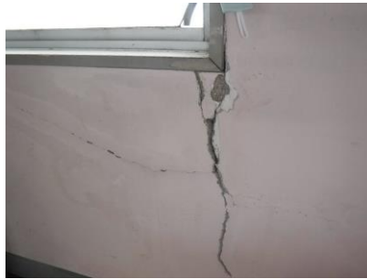
躯体のひび割れ
