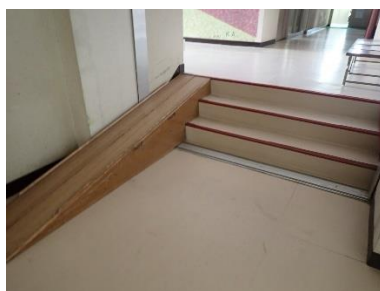
校舎内の段差
