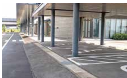
▲沈下した道路（愛西市総合斎苑）
