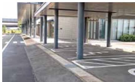
▲沈下した道路（愛西市総合斎苑）
