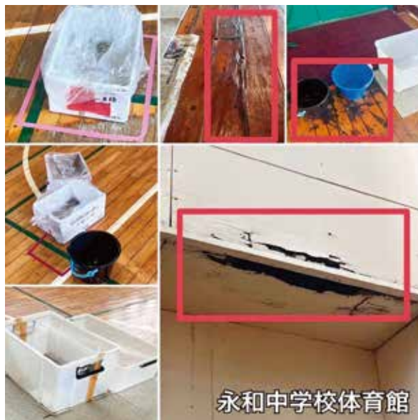
▲雨天時の対策(赤枠は雨漏りによる腐食)
