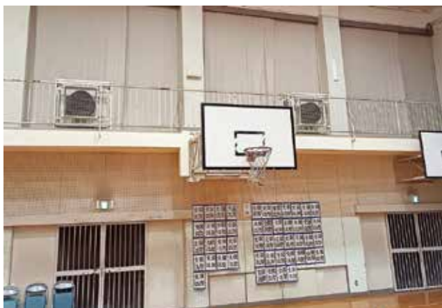
▲佐織西中学校に整備した空調設備
