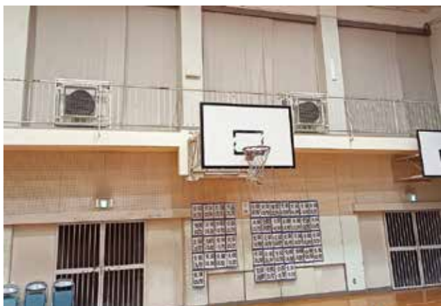
▲佐織西中学校に整備した空調設備
