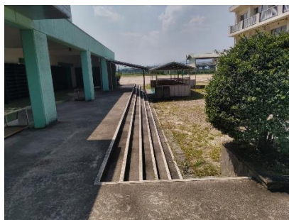
出入口の段差
