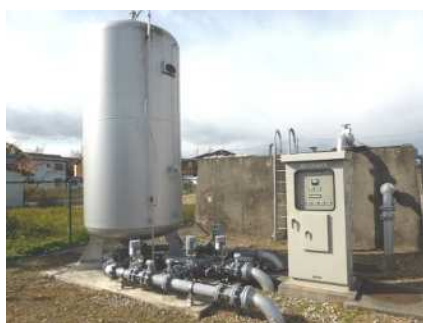
佐織西部浄水場の急速ろ過機
