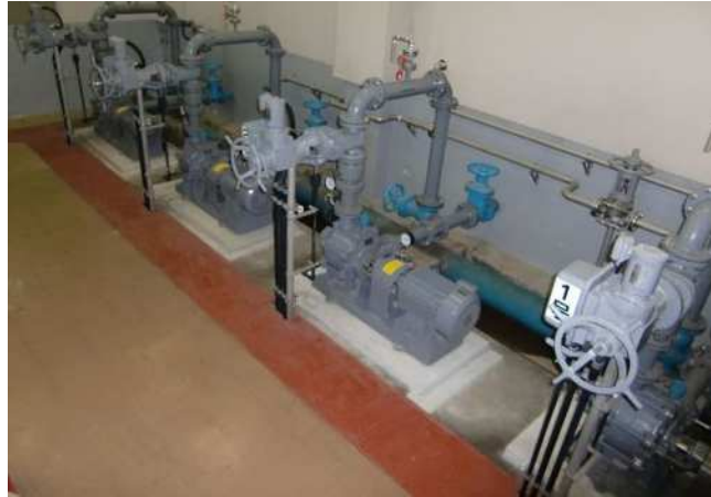
八開浄水場の配水ポンプ
