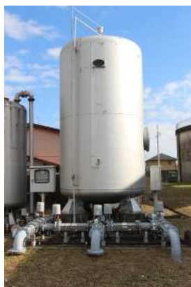
佐織中部浄水場の急速ろ過機
