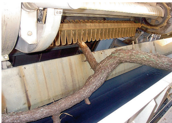
排水機場で回収された倒木
