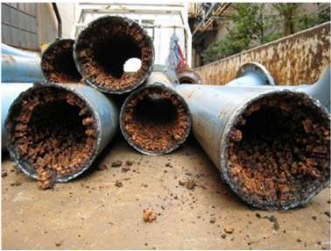
老朽化した水道管（サビ）
