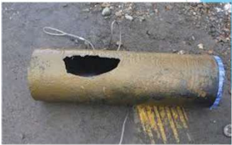
老朽化した水道管（破損）
